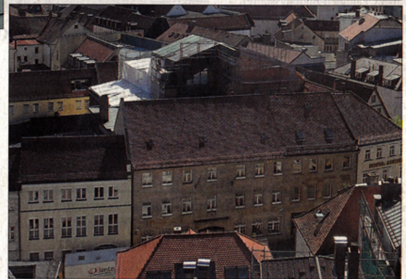
Aus der Vogelperspektive: Teile des sanierungsbedürftigen Dachs wurden abgetragen, um den neuen Tagungsbereich aufzusetzen. Renno: nk
